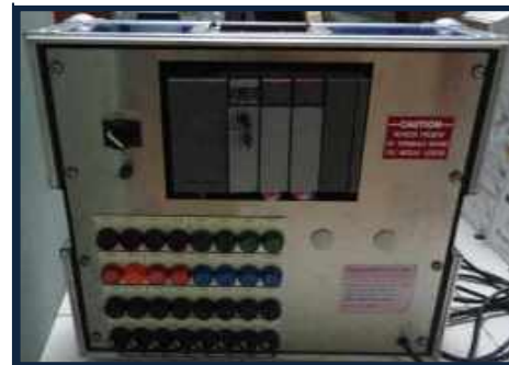
Allen Bradley SLC 5/03
