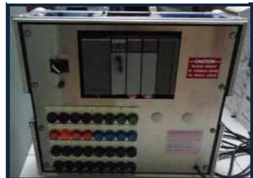
Allen Bradley SLC 5/03
